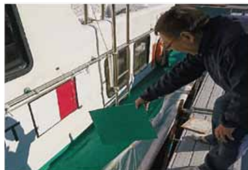
▲ この辺りはタグと接舷する部分だからデッキが痛みやすいので、定期的に板を張り替えて補修しています。
