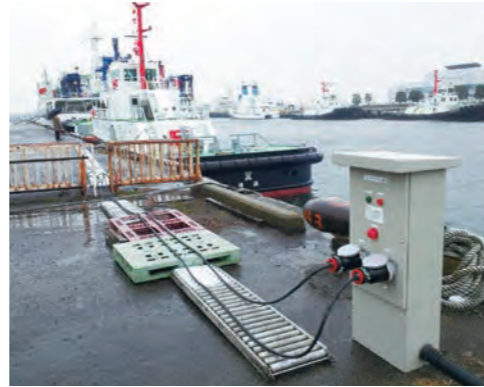
陸上の給電設備
