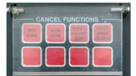
▲ オーバーライドスイッチは蓋を開け操作するWアクションになっている
