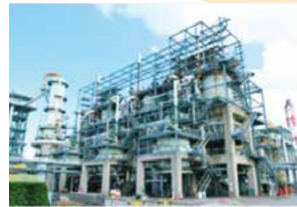
減圧残油熱分解装置(ユリカ装置)
