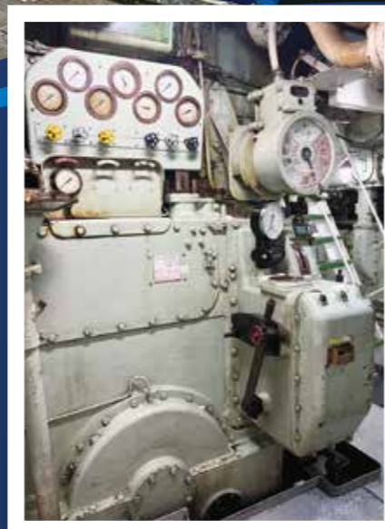
▲ 整備されたエンジンルーム
