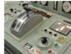
船橋主機遠隔操縦装置
